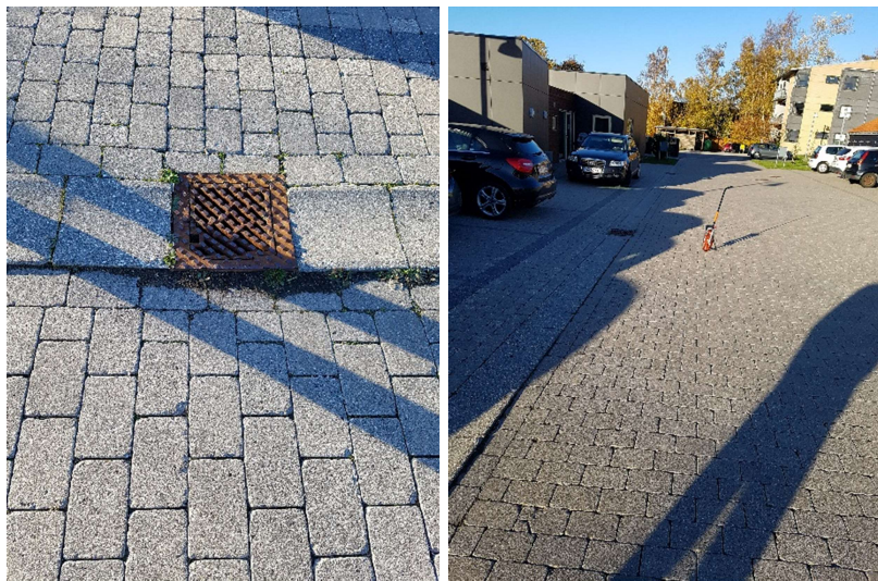
Figur 2.7 - Betonbelægning med lokale sætninger.
