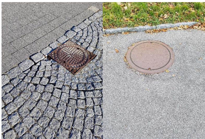
Figur 2.4 – Manglende fugemateriale samt revner omkring dæksel.
